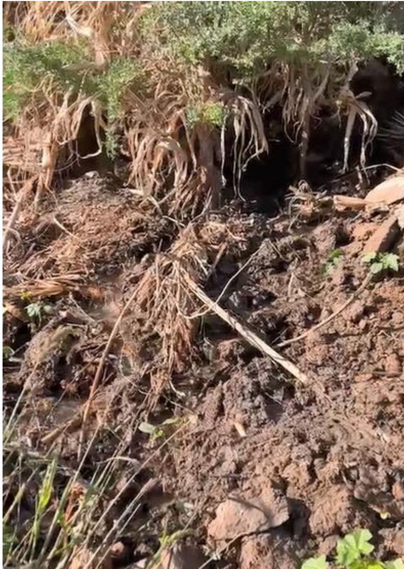
Imagen: Muro Colapsado
