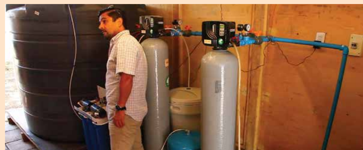
Figura 85. Equipo de Osmosis Inversa que abastece el sistema de cultivo hidropónico.
