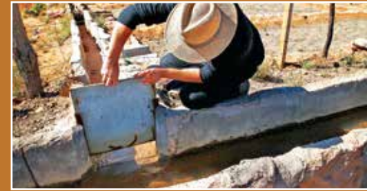
Figura 5. Compuerta metálica que permite la distribución del agua de riego al interior del predio.
