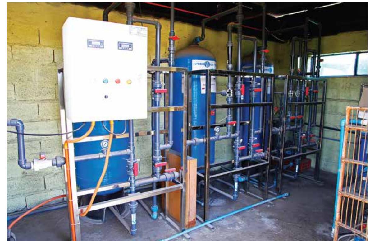
Figura 97. Planta de tratamiento de osmosis inversa con capacidad de proceso de 1.000 litros/hora, cuenta además con dos filtros para el abatimiento de boro y arsénico.
